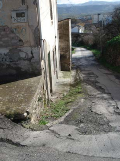
Detalle de caída a distinto nivel desde el cruce con la calle Camino Jacobeo sin barandilla de protección ni detección en pavimento.
