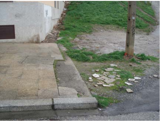
Piezas finales del tramo deterioradas.
