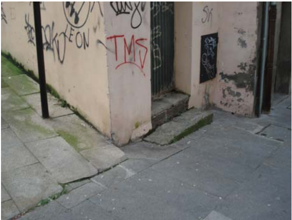
Peldaño particular invasivo al espacio público sin señalizar con barandillas laterales o elementos de mobiliario.
