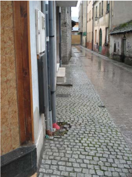
Deterioro de adoquines y existencia de escalón saliente al espacio público que debería estar señalizado (o con 2 elementos de mobiliario o 2 barandillas) para evitar tropezar a usuarios invidentes.
