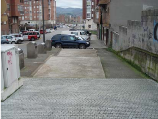
Acera de hormigón deteriorado y con escalones
