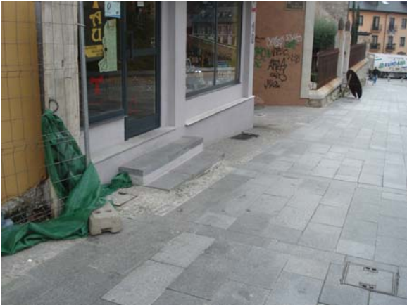
Otro peldaño invasivo y vallado de obra poco recomendable por ser tropezable su peana de apoyo
