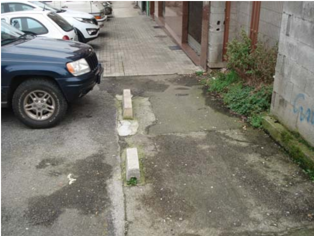
Tramo de acera con pavimento de hormigón con resaltes y bordillos sueltos peligrosos por tropiezos
