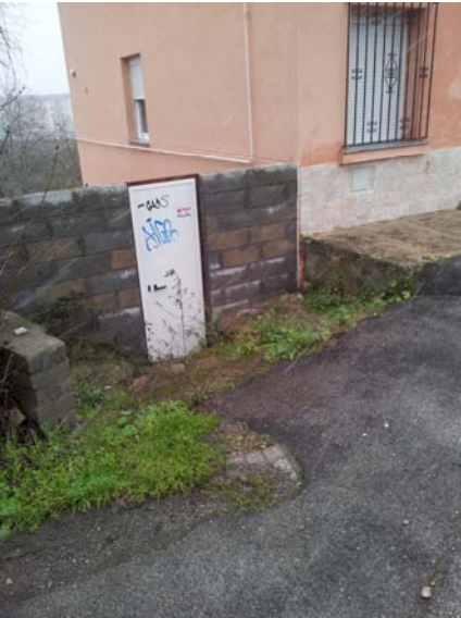
Ubicación de desnivel peligroso sin referencia de orientación de ancho
