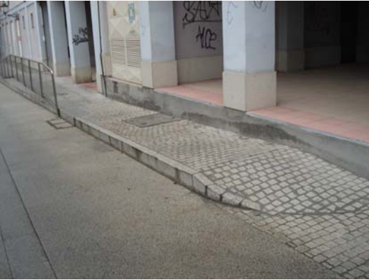
Inicio de rampa. a=1,80 m. Falta tramo de barandilla
