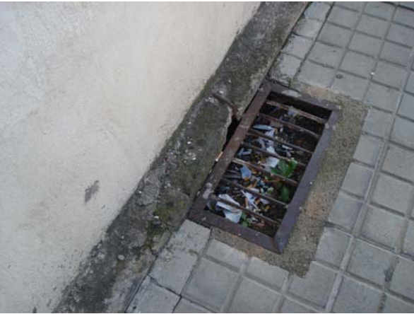
Rejilla de pluviales en acera con abertura de 2,3 cm.
