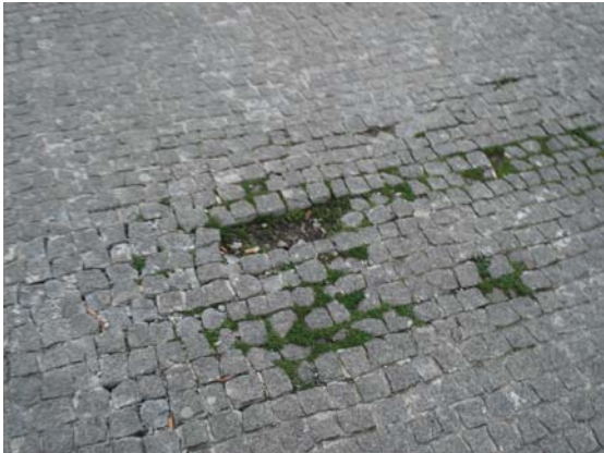
Adoquinado suelto y deteriorado en puntos localizados
